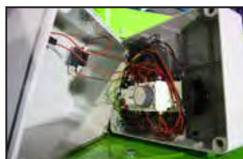
Coffret électrique avec indice de protection IP657.
